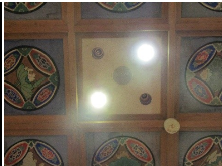
↑ 本堂外陣の照明 二ヶ所点灯していない。
