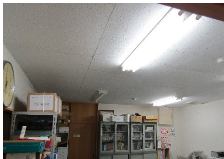
↑ 事務所の照明 奥の照明は器具の故障により蛍光灯を外している。
